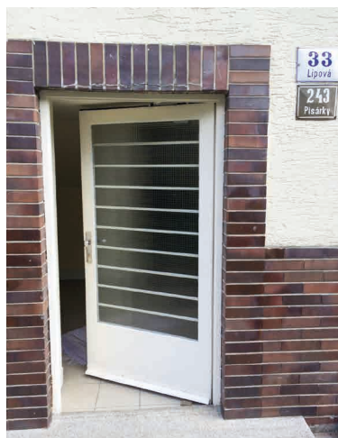
Vchodové dveře a základy domu na Lipové 33 s obkladem podobným jako na Křenové 14. Foto: autorka. Door and foundation at Lipová 33 with similar tile to Křenová 14. Photo: author.
